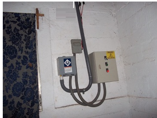
Immagine 5: Pannello di controllo pompa
