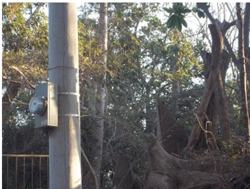
Immagine 4: Parte del nuovo sistema elettrico
